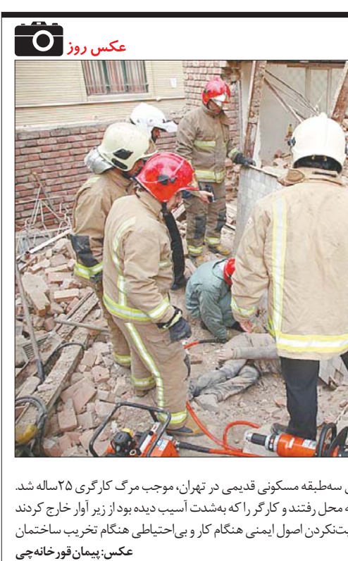
ریزش آوار هنگام تخریب ساختمان سه‌طبقه مسکونی قدیمی در تهران، موجب مرگ کارگری ۲۵ساله شد.
