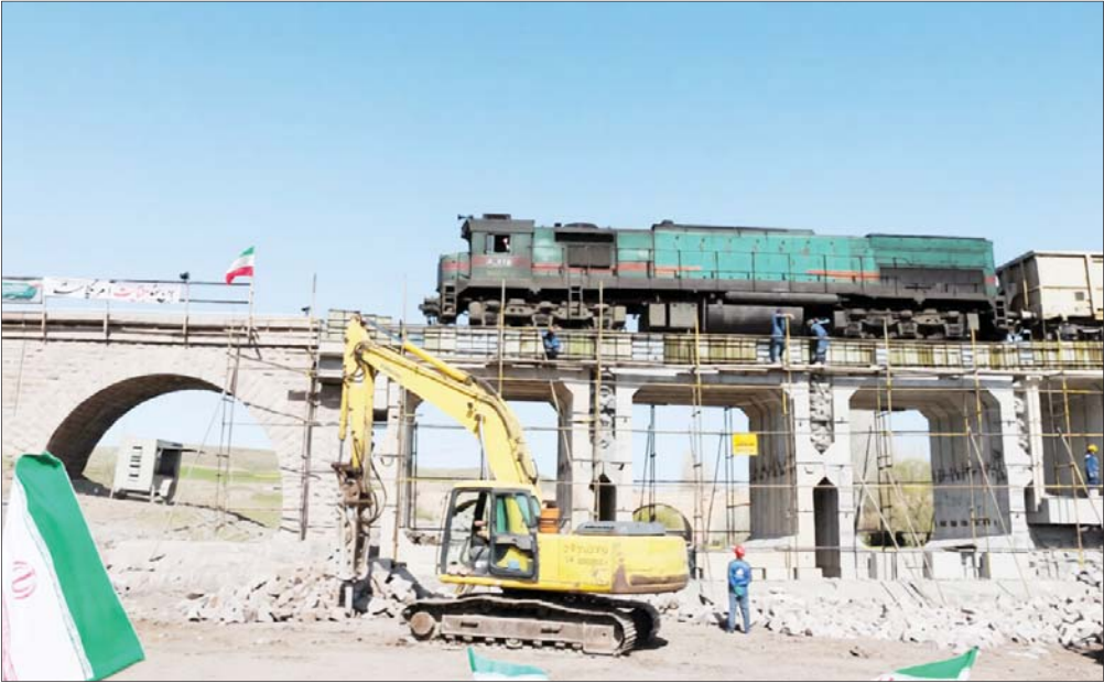
پل راه‌آهن امین‌آباد زنجان که حدود ۳۵ متر از عرشه پل و ۱۵۰ متر از خطوط ریلی آن به دنبال حملات تجاوزکارانه آمریکا و رژیم صهیونیستی به زیرساخت‌های کشور در روز سه‌شنبه ۱۸ فروردین ۱۴۰۵ تخریب شده بود. در طول چهار روز بازسازی شد. هم‌زمان با بهره‌برداری مجدد پل و اتصال خط ریلی کشور به شمال غرب، تجمع مردمی با هدف قدردانی از عوامل بازسازی پل برگزار شد. عکس: احسان تقی‌بیکو، ایسنا
