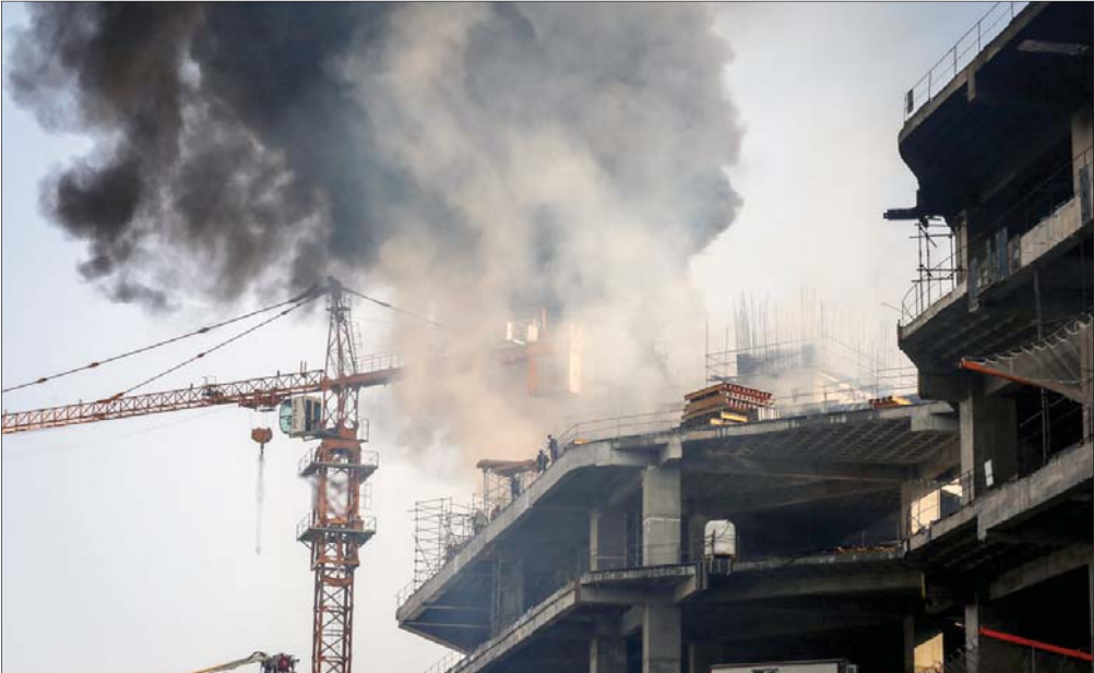
انبار ضایعات یک ساختمان نیمه‌کاره در حاشیه بزرگراه نیاپش غرب، تقاطع خیابان ولی‌عصر، عصر دوشنبه ۲۹ مرداد طعمه حریق شد. به دلیل سرایت آتش به تیرهای چوبی ساختمان در حال ساختن، حریق به بخشی از طبقات این ساختمان سرایت کرد که مأموران پنج ایستگاه آتش‌نشانی، آتش را مهار کردند. عکس، محسن ونایی، ایرنا
