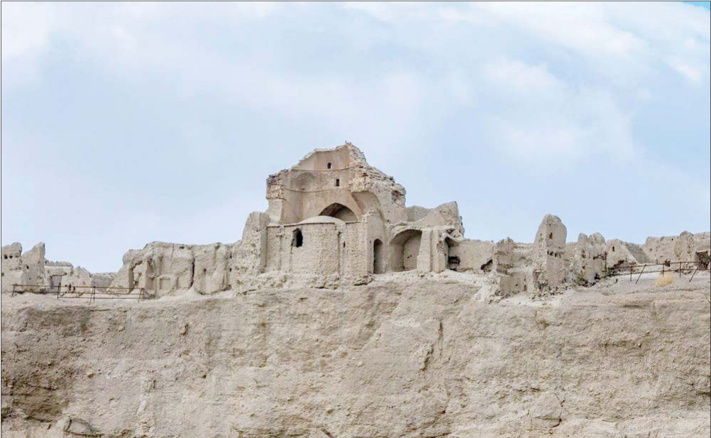
قلعه ساسانی ایزدخواست شهرستان آباده که از آن به‌عنوان نخستین بنای طبقاتی خشت و گلی دنیا نام می‌برند و قدمت آن ۱۷۰۰ سال پیش می‌رسد، به‌دلیل نفوذ رطوبت از چند قسمت دچار شکاف‌های عمیقی شده است. به گفته کارشناسان و محققان میراث فرهنگی، این بنا به علت نبود نظارت و نگهداری اصولی با صدمات جدی از جمله شکاف‌های عمیق و تخریب کامل بعضی از قسمت‌های دست و پنجه نرم می‌کند. عکس: علی آذر، باشگاه خبرنگاران جوان
