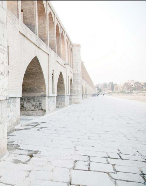
پله‌های تاریخی اسفهان از فقدان آب که به وجود آنها معنا و مفهوم می‌بخشد، رنج می‌برند و در این شرایط، با آسیب‌های مختلفی نیز دست و پنجه نرم می‌کنند؛ از یادگاری‌نویسی‌های ریز و درشت و تخریب‌های انسانی گرفته تا ترک‌های نگران‌کننده‌ای که متأسفانه پژوهش دقیقی برای تشخیص منبع ایجاد آن انجام نشده است. برخی این ترک‌ها را به نشست برخی به فرونشست و برخی به مرمت‌شدن مداوم یا مرمت‌های غیراضولنی بنا نسبت می‌دهند. عکس: عادل شیرانی، ایستا
