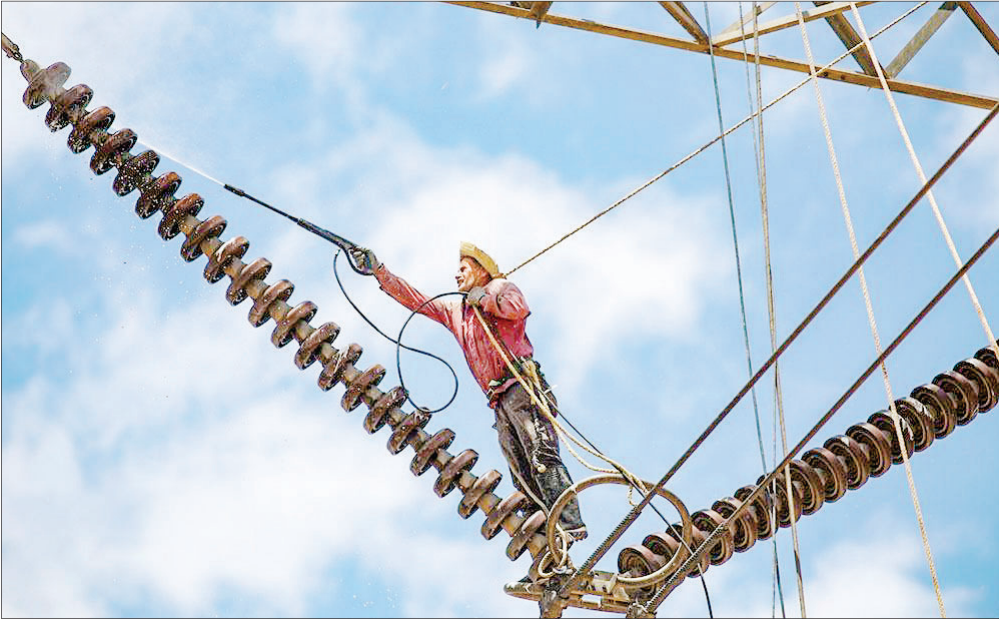
در پی افزایش آلودگی در جنوب استان کیلان ناشی از وجود معادن و کارخانه‌های صنعتی مستقر در منطقه و با توجه به اثرات ناشی از این آلودگی بر مقره‌های خط ۴۰۰ کیلولت نیروگاه کیلان-نیروگاه شهید رجایی، عملیات تعویض و شست‌وشوی مقره‌های آلوده در پنج گروه کاری انجام شد. اجرای این اقدام نقش مهمی در افزایش قابلیت اطمینان خط و پیشگیری از بروز هرگونه حوادث احتمالی و بهبود شرایط بهره‌برداری داشته است. عکس: الهه فلاح، باشگاه خبرنگاران جوان
