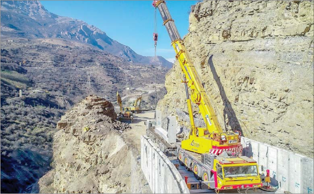
با ورود ماشین‌های سنگین راهسازی، عملیات ایمن‌سازی و بهسازی جاده کندوان در حال انجام است تا مسافران در این جاده قدیمی سفری امن را تجربه کنند.عکس: ولی شجاعی، میزان
