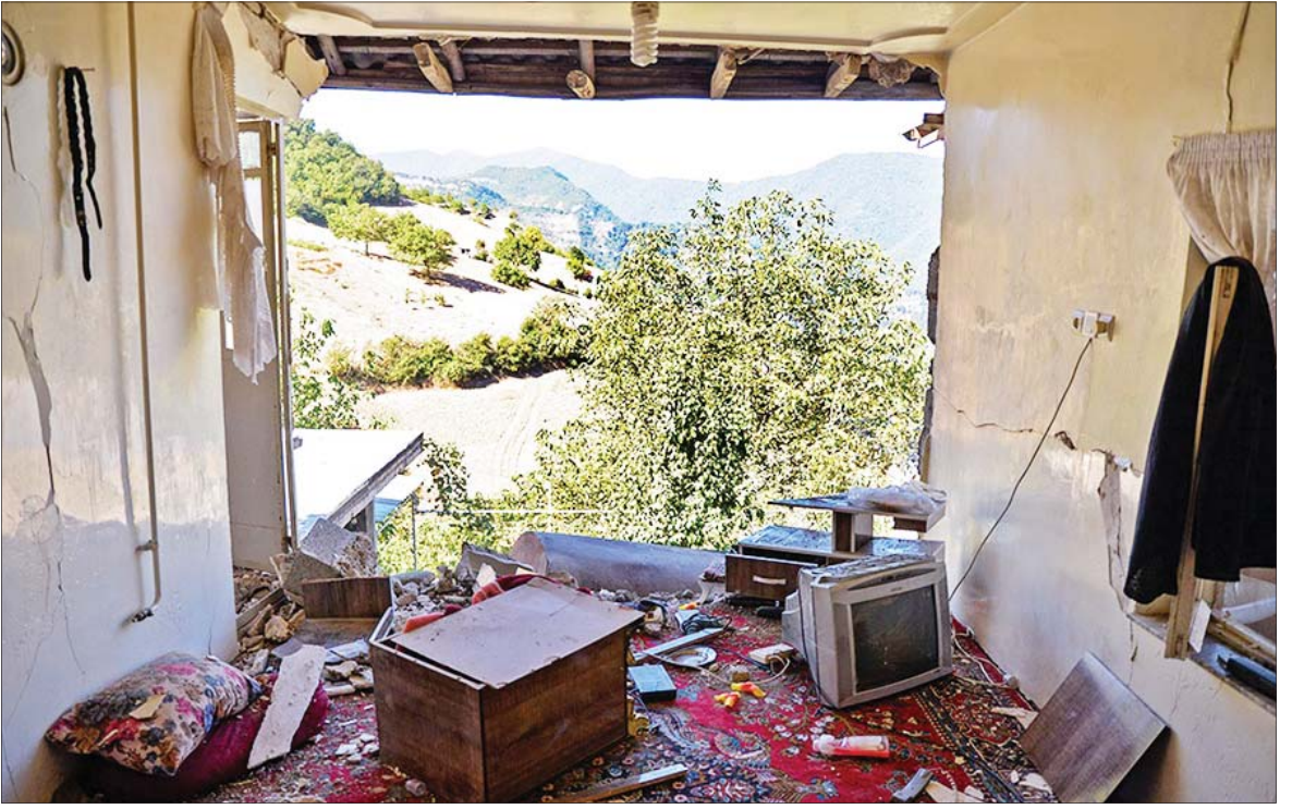
تخریب ساختمان‌ها بر اثر زلزله ۵٫۱ ریشتری روستای رامیان استان گلستان. عکس: علی دهقان، فارس
